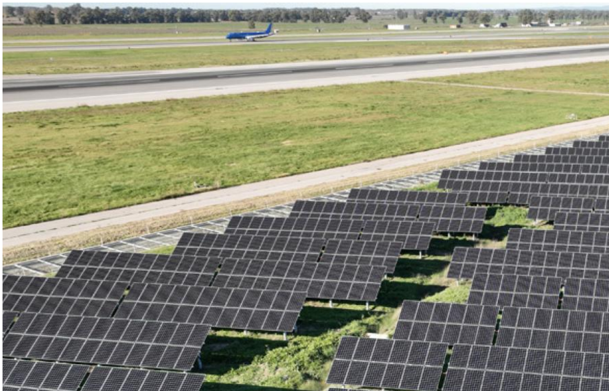
La solar farm di Pista 3
