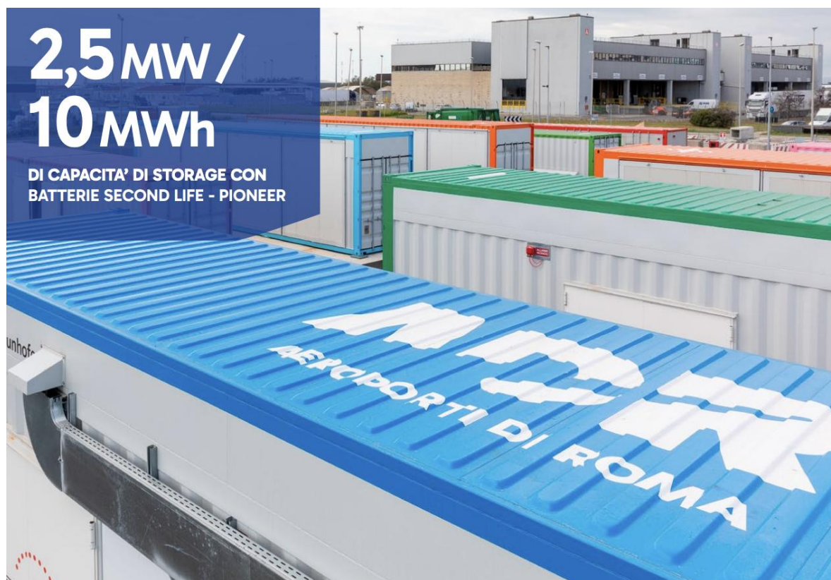
Impianto batterie di accumulo energetico
